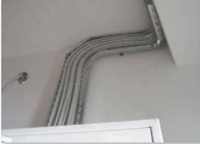
Kablolar bina içerisinde tek bir kanala döşenirler.
