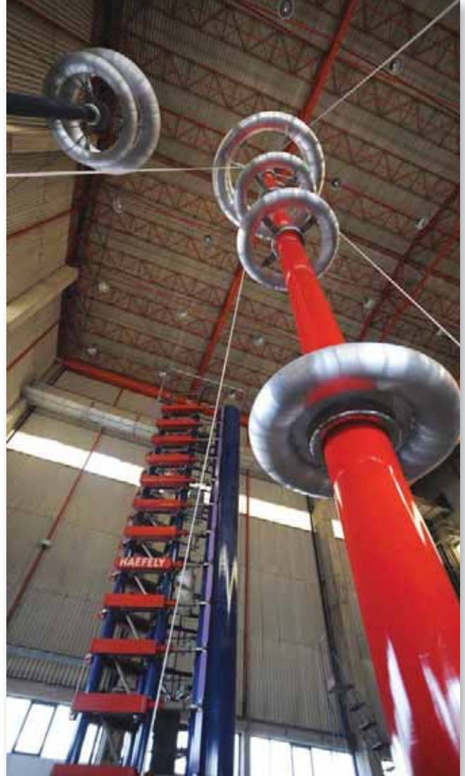
Yıldırım darbe jeneratörü gerilim bölücü.
